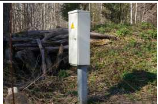
Zemes gabals ar kadastra apzīmējumu 6464 002 0037, elektrosadalne un uzskate
