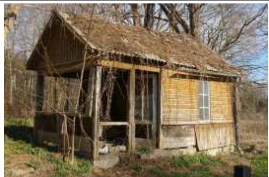
VZD Kadastrā reģistrā fiksēta, bet Kalētu pagasta zemesgrāmata nodalījumā Nr.100000504445 neregistrēta pirts ēka ar kadastra apzīmējumu 6464 002 0037 002
